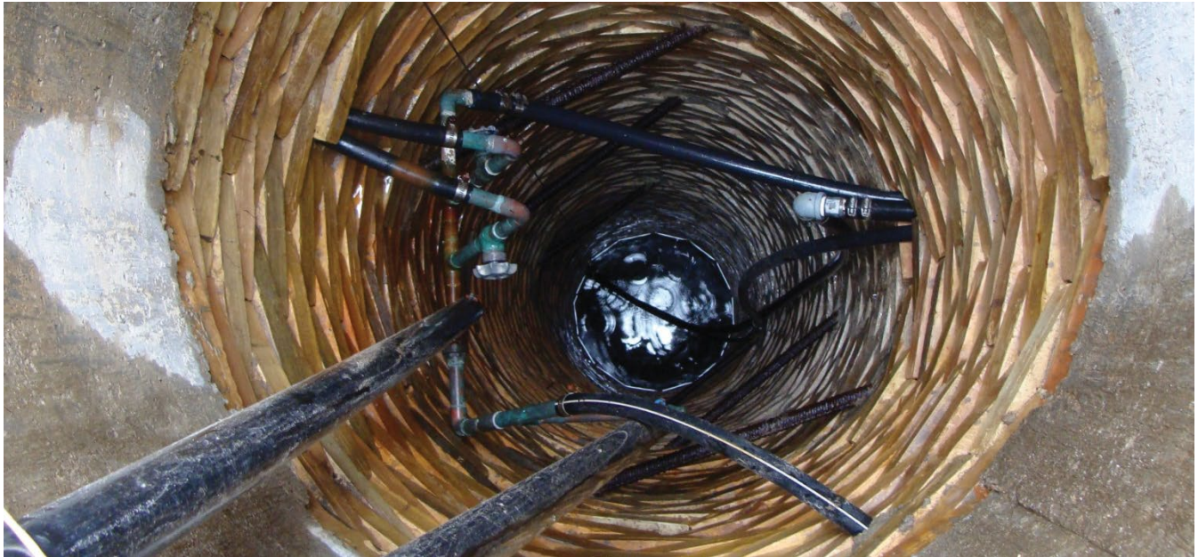
Puits creusé il y a plus de 100 ans. L'humidité que l'on voit sur le béton et sur le tubage de tuiles indique que les eaux de surface se déversent dans le puits. Il faut veiller à ce que le puits soit bien construit et entretenu pour réduire la contamination potentielle à l'intérieur du puits.
